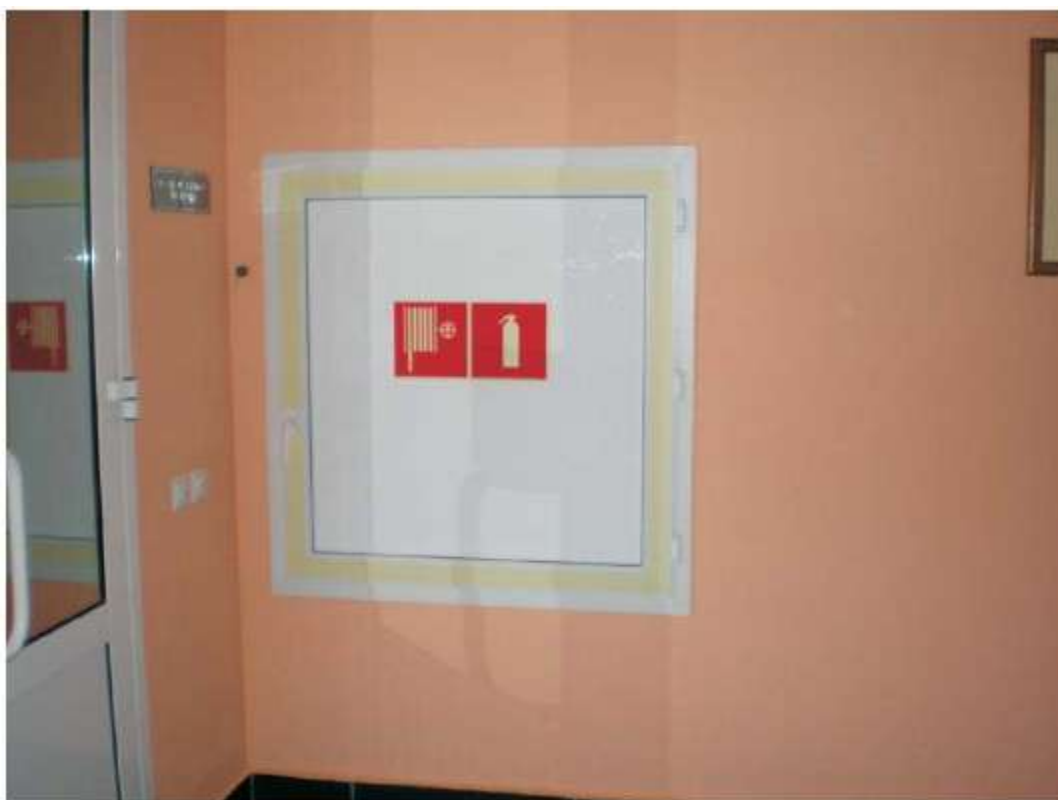
Рисунок А.6 - Обозначение фотолумinesцентной 50-мм лентой контура пожарного оборудования и использование знаков пожарной безопасности
